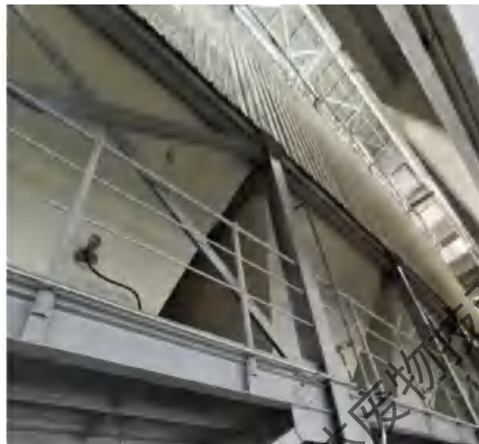
焚烧炉烟气处理-布袋除尘器
