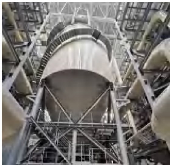
焚烧炉烟气处理-脱酸塔
