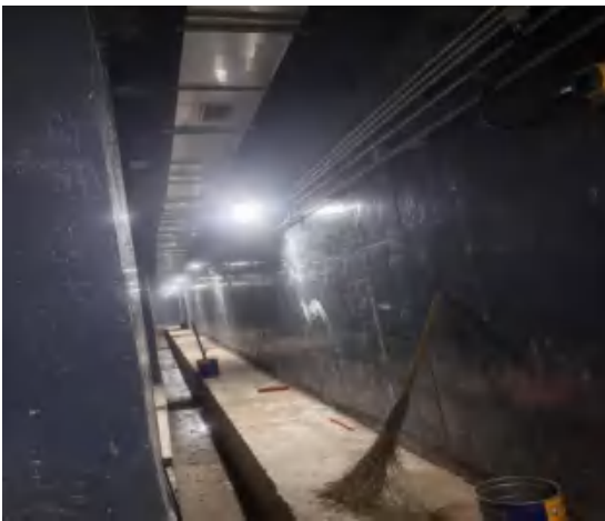
车间渗滤液收集
