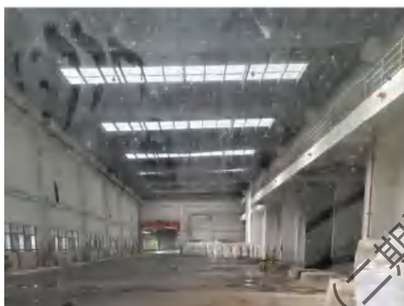
垃圾卸料大厅
