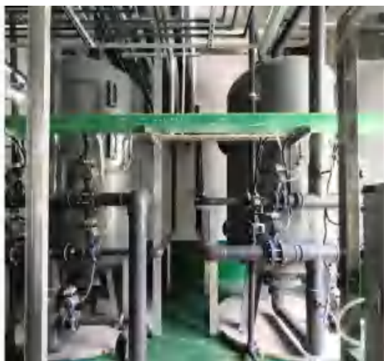
工业废水处理（多介质过滤）
