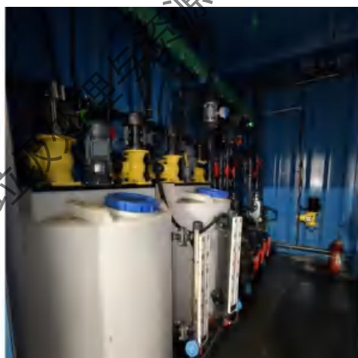
生活污水处理（MBR一体化生化系统）
