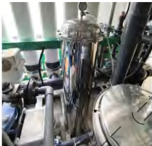
工业废水处理（保安过滤器）
