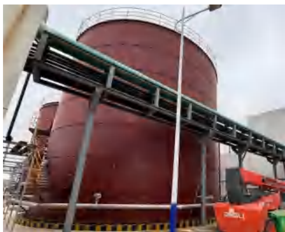
渗滤液处理（UASB）
