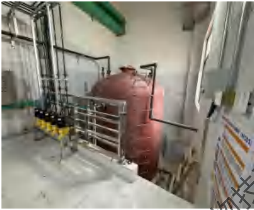
盐酸储罐区（围堰、收集沟渠等）
