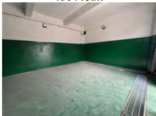
危废间防渗及收集
