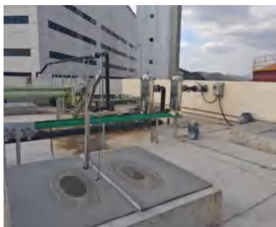
渗滤液调节池（预处理）
