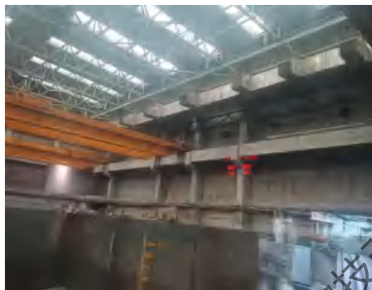
垃圾储坑吸风口
