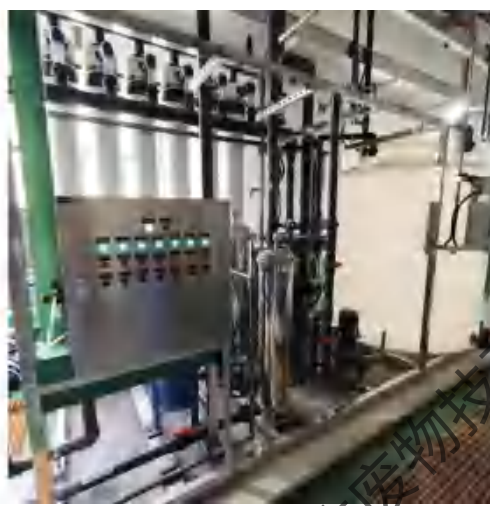
工业废水处理（超滤）
